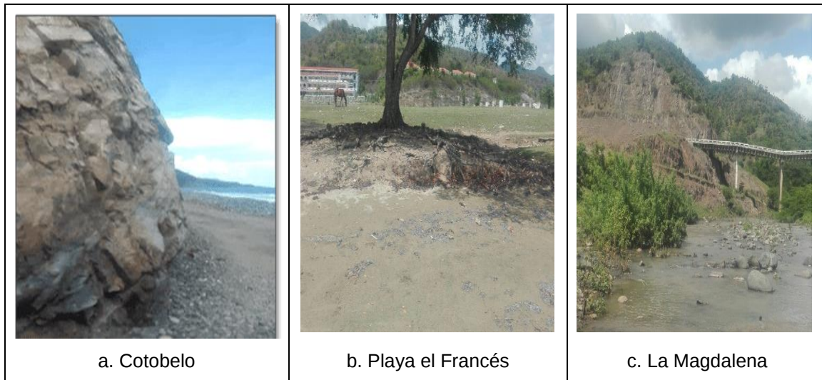
Figura 11. Influencia de la erosión marina en el talud (a), compactación del suelo y pérdida de arena (b) y erosión en laderas y acumulación de material en el río (c). Fotos tomadas por Leonor Villalón Poulut, 2022.
