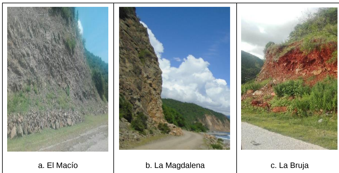
Figura 19. Ejemplos de caídas (a) y desprendimientos (b, c) en el área. Fotos tomadas por Leonor Villalón Poulut, 2022.
