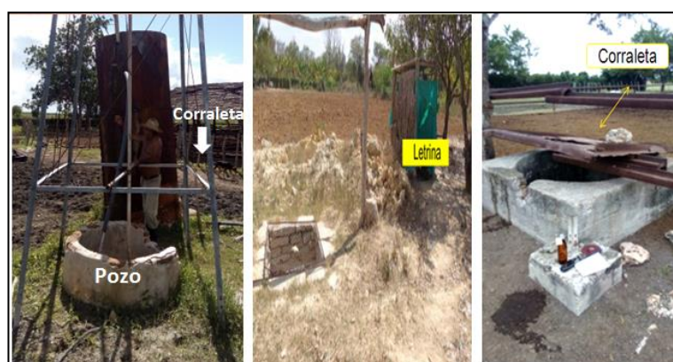
Figura 7. Pozos destapados, con letrinas, corrales y corraletas en sus alrededores.
