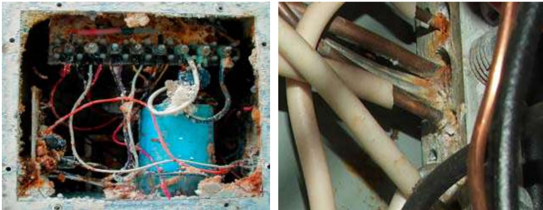
Figura 1.1. Corrosión del cobre en conductores eléctricos. Fuente: Morcillo (2002).
