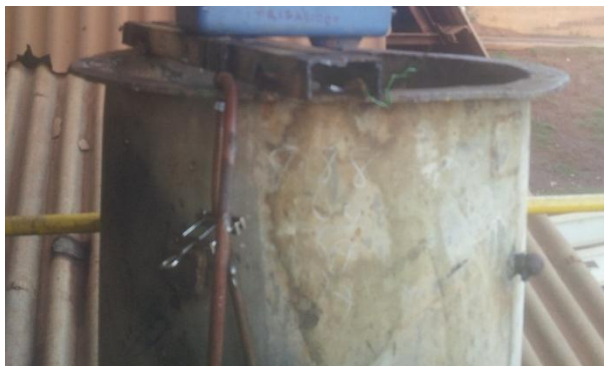
Figura 7: Tanque para la preparación y dosificación de floculante.
