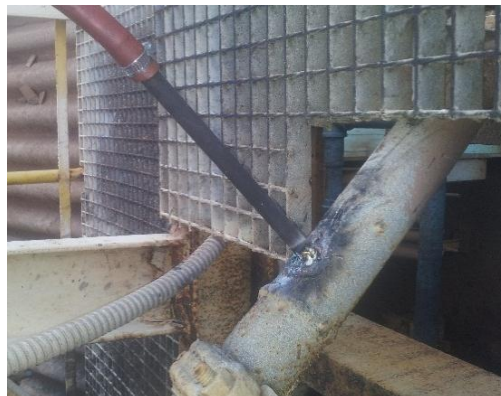
Figura 10: Punto de dosificación de la solución de floculante.
