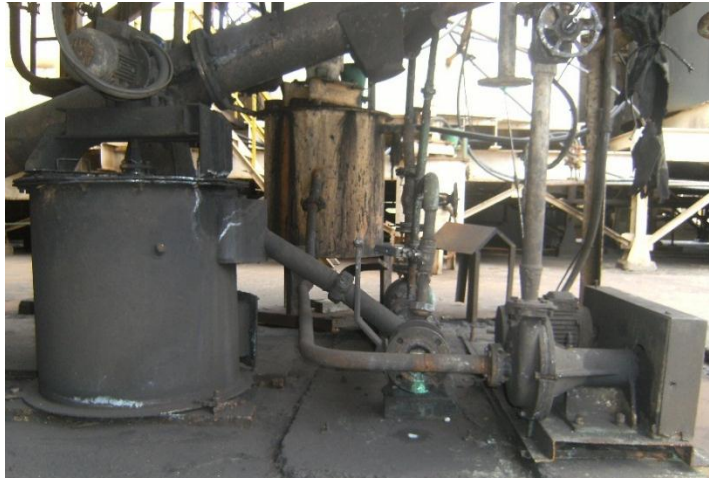
Figura 3: Tanque de Contacto y la bomba centrífuga
