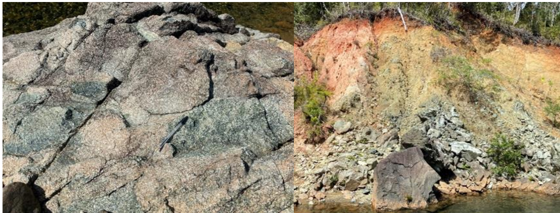
Figura 12. Deslizamiento la curva.
