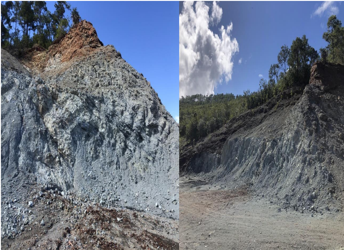
Figura 22. Cantera de préstamo de rocas serpentinizadas alteradas.
