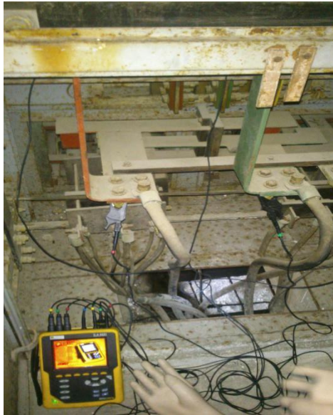
Figura 2.8 Conexión del Analizador de redes
