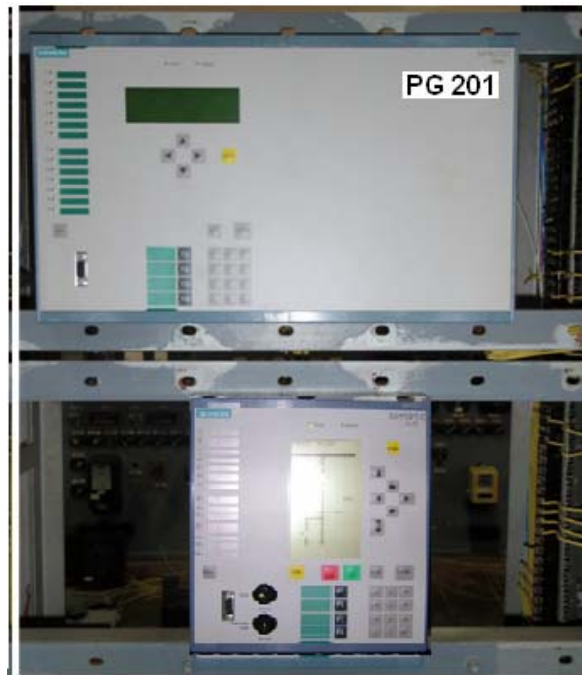
Figura 2.2. Relés digitales instalados en el panel (P20).
