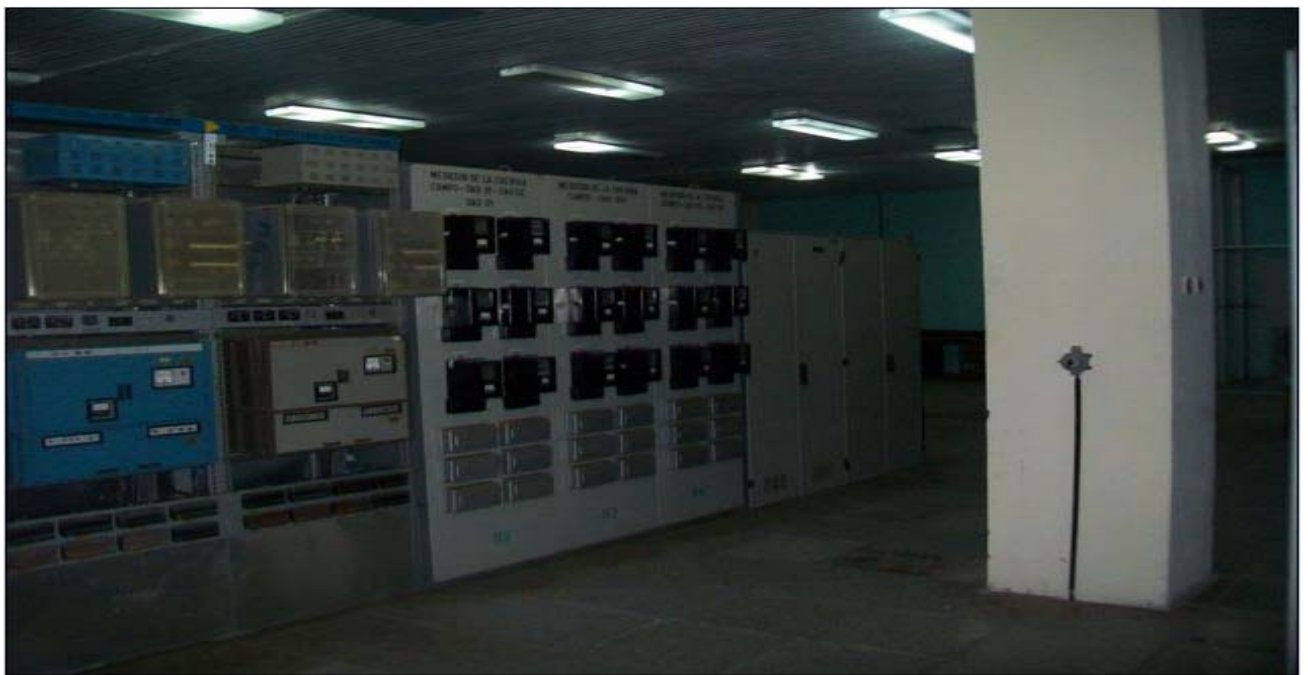
Figura 2: Estado actual del sistema de alumbrado.
