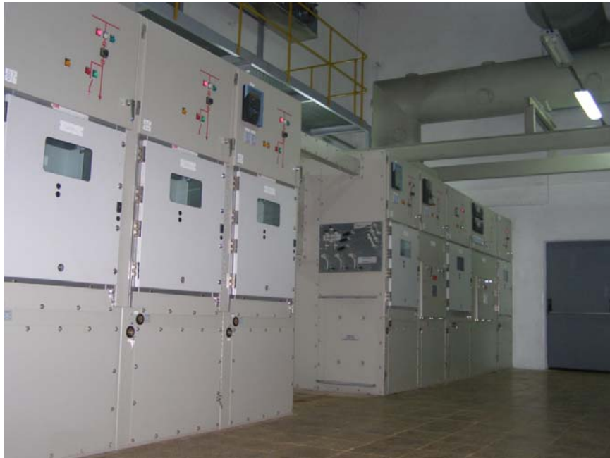
Figura 2.2t Local donde se encuentran instalados los B90 de la SB4
