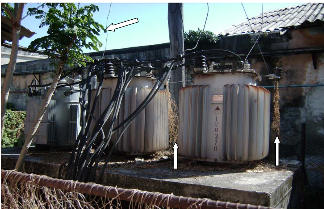
Foto # 4. Suciedad en el banco de Transformadores # 2.
