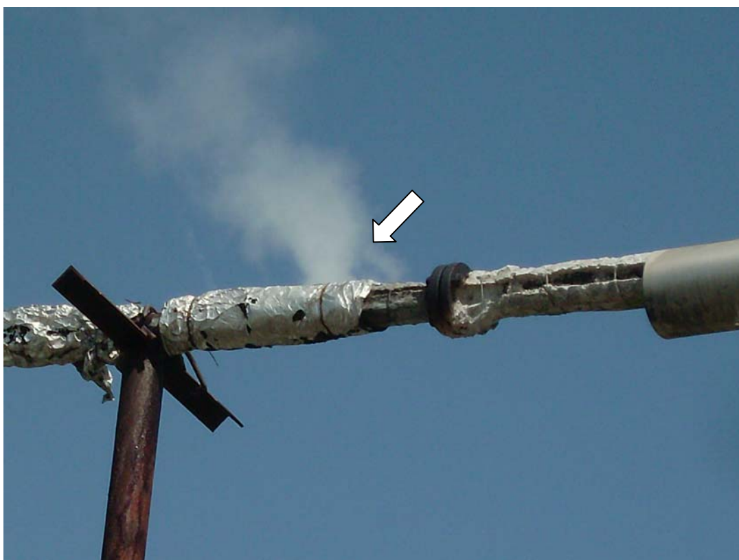
Foto # 1. Falta de insulación en las tuberías, provocando salideros de vapor.
