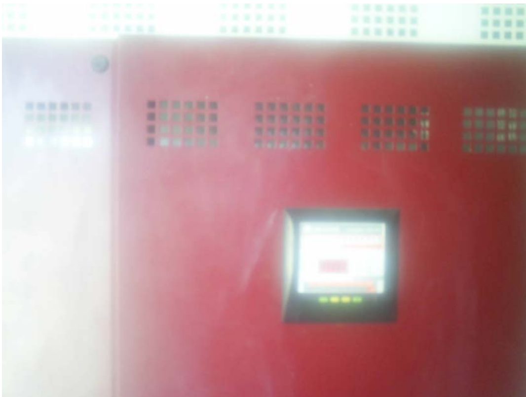
Circuitor del banco de condensadores automático.
