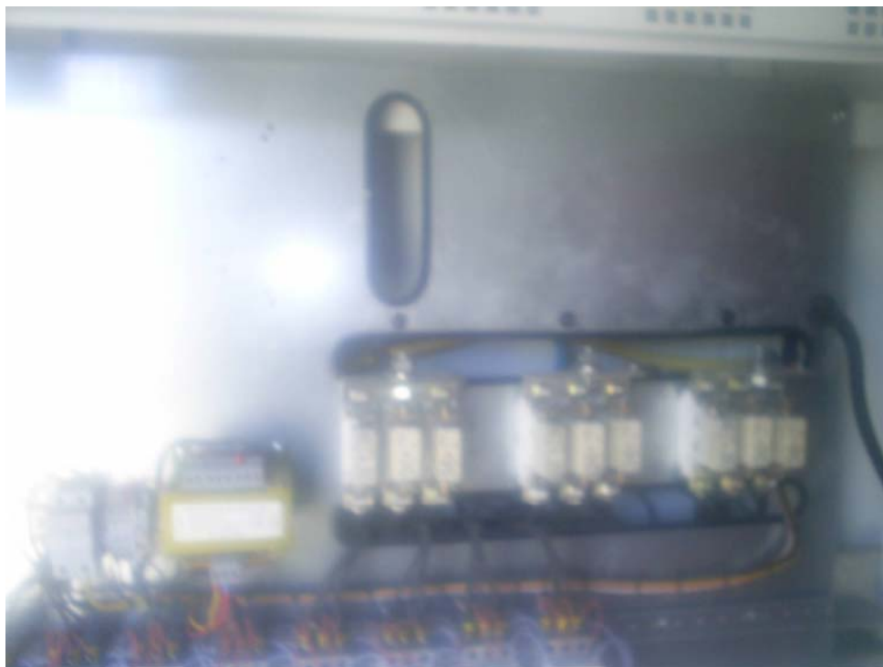
Protección de los condensadores del banco
