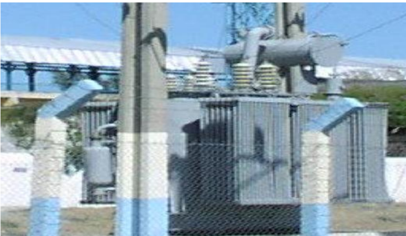
Figura: 2.2 Transformador de uno de los Circuitos de prueba.
