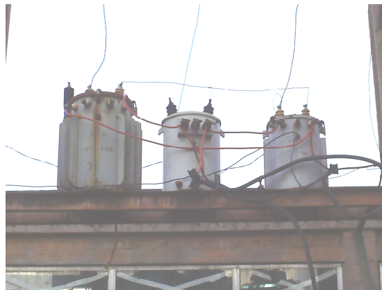
Banco de Transformadores de Residencia.
