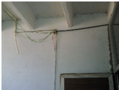
G) Tendedera eléctrica del cuarto #412.
