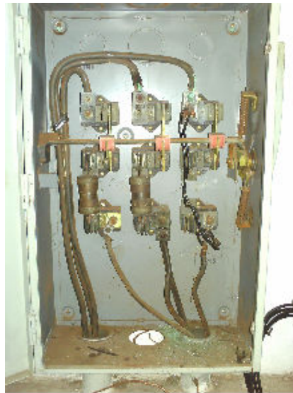
E) Interruptor de la bomba de agua.
