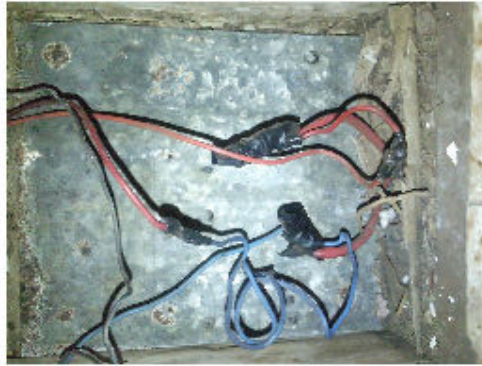
I) Conexión directa a la línea sin dispositivo de protección (P2, Edificio #4).
