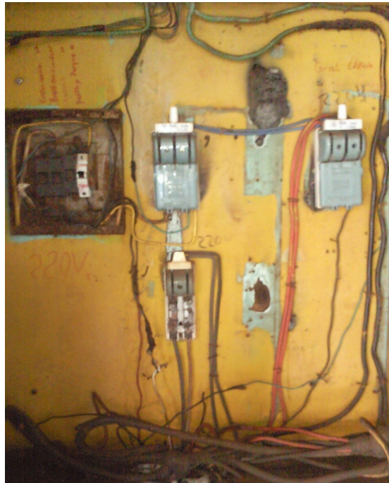
Panel del edificio #2.
