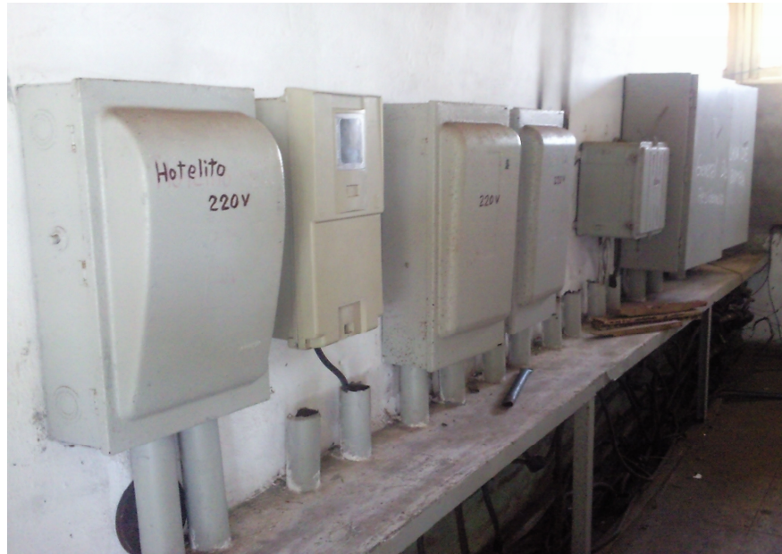
Panel general del Banco de Transformadores de Residencia.
