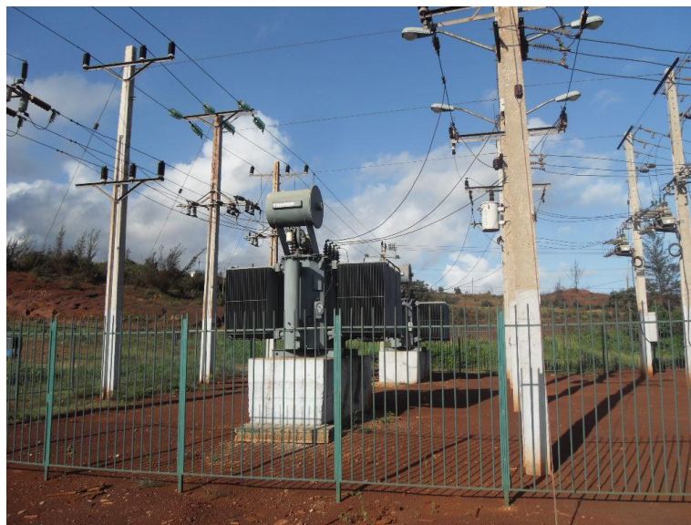
Figura 2.2 Transformadores de la subestación Moa Nueva.
