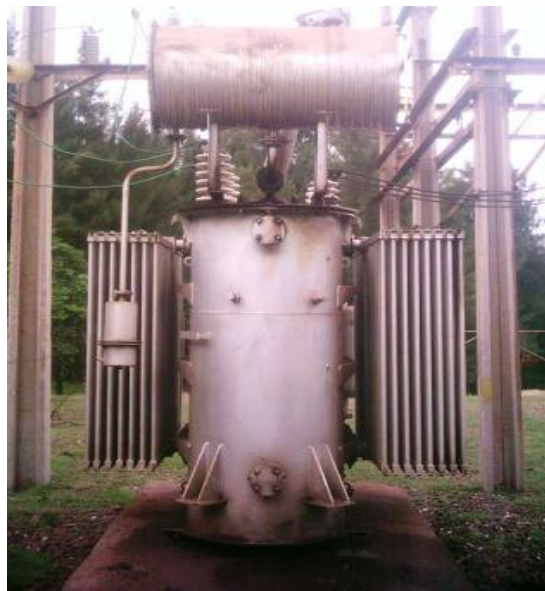
Figura 2.4 Transformador de la subestación Vivienda Checa.
