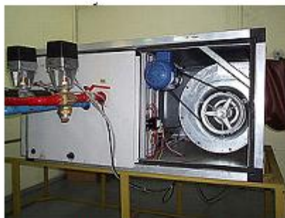
Unidad manejadora de aire de 5 Unidad manejadora con gabinete abierto para inspección del ventilador centrífugo
