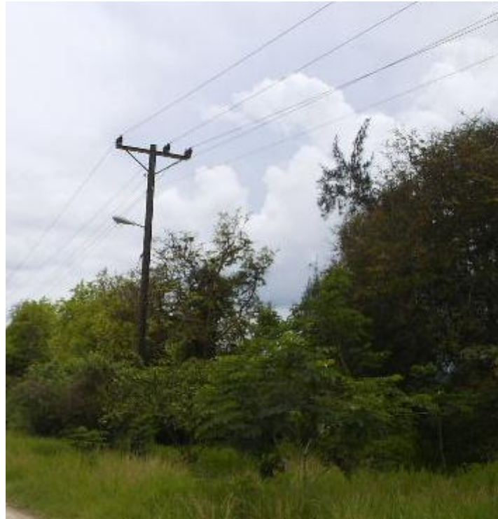
Figura 3.1 Vista general de una línea de 13.8 kV
