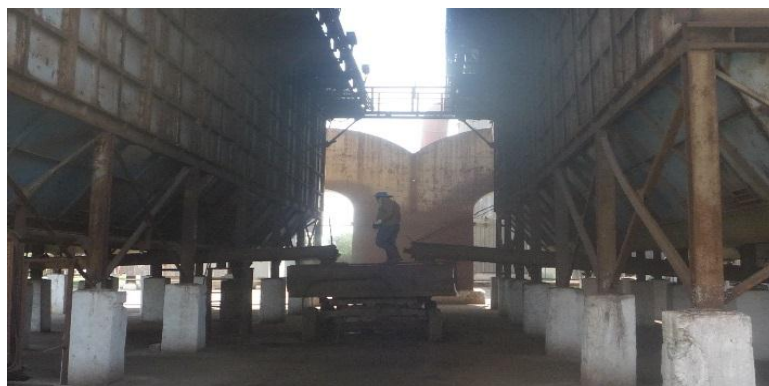
Figura 2.1. Planta de depuración de gases en la Empresa Acinox - Las Tunas, compuesta por filtros de manga y transportadores sinfines.
