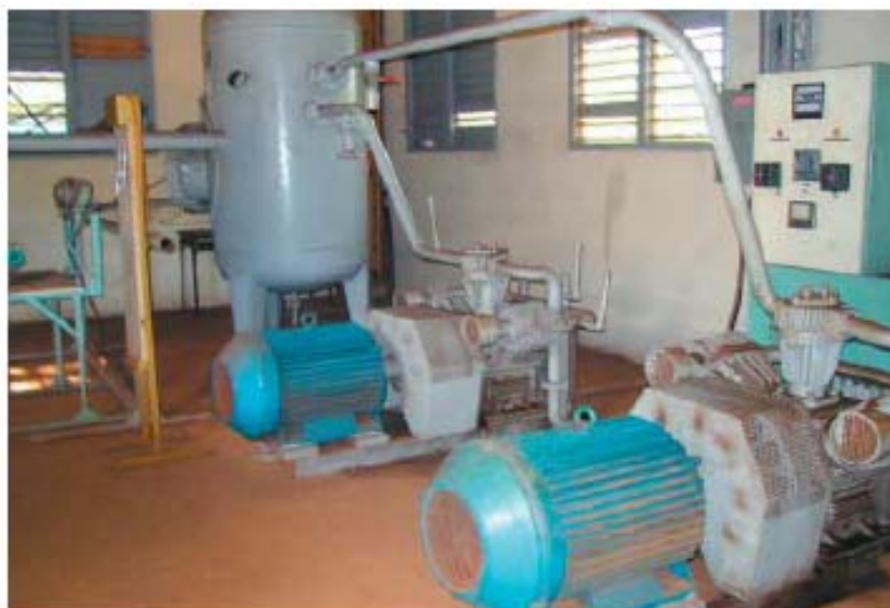
Figura 2. Foto de la instalación de compresores del ISMM
