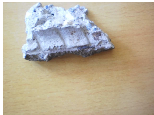
Anexo 8. Muestra 2 de concreto.
