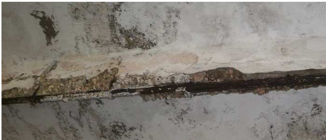
Figura 3.5. Corrosión generalizada de las armaduras acelerada por cloruros bajo los efectos de las filtraciones y deterioro de las estructuras de hormigón en el pasillo trasero del Laboratorio de Ciencia de los Materiales.
