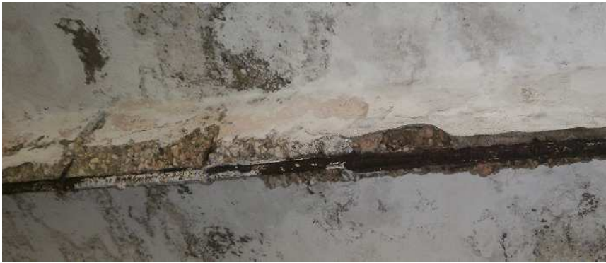
Anexo 6. Corrosión generalizada de las armaduras acelerada por cloruros bajo los efectos de las filtraciones y deterioro de las estructuras de hormigón en el pasillo trasero del Laboratorio de Ciencia de los Materiales.
