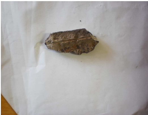
Anexo 7. Muestra 1 de concreto.
