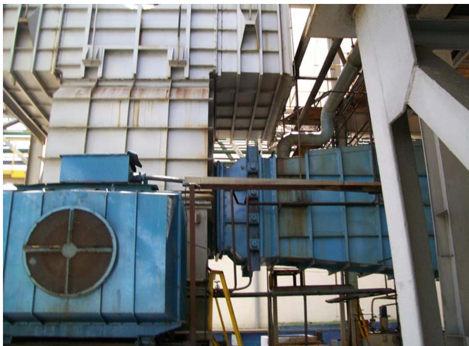
Anexo 6: Ventilador de tiro forzado de la unidad 1 de la empresa termoeléctrica de Felton.
