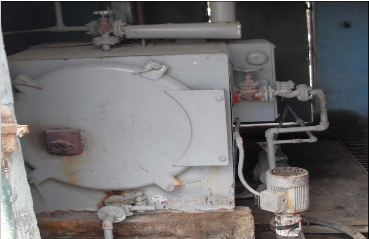
Figura 1.2. Generador de vapor ubicado en la planta de Asfalto.
