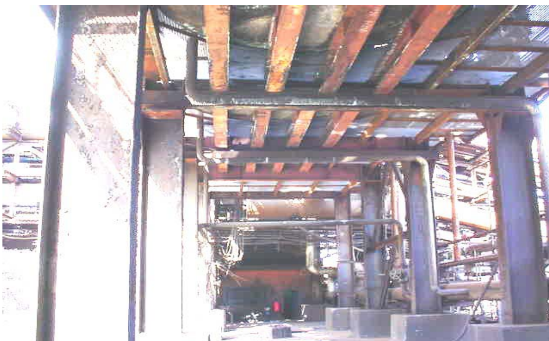
Vista inferior de la miniserie C afectada por la corrosión
