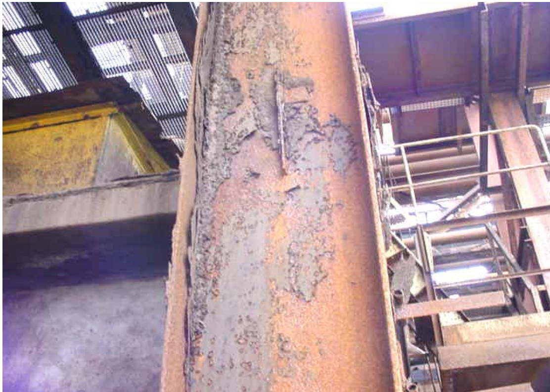
Columna afectada por la corrosión
