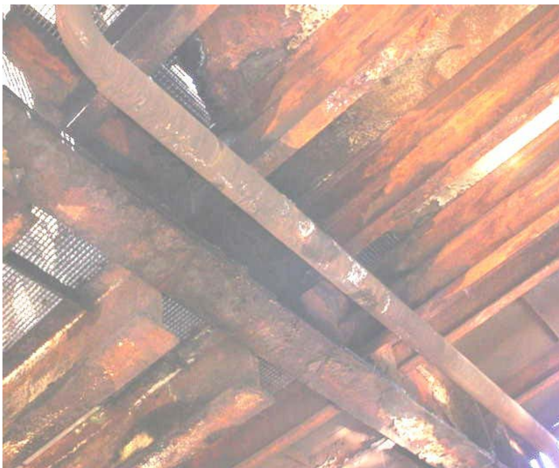
Vigas afectadas por la corrosión
