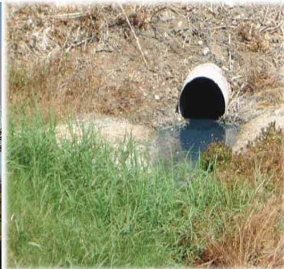
Fig. 4. Vertimiento de residuales industriales.
