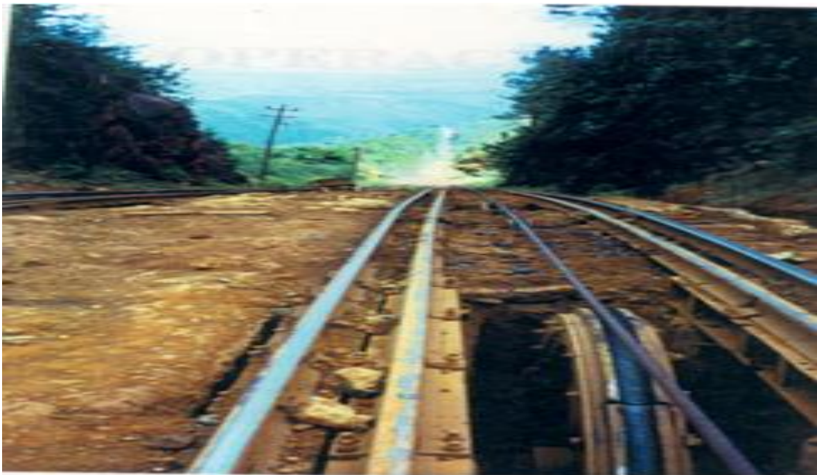
VIA FERREA CON EL SISTEMA DE CABLE
