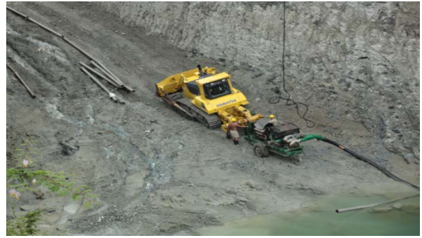
Foto N°.5. Equipamiento para el drenaje de la minas.
