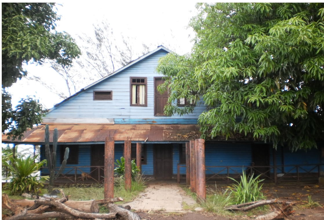
Ilustración 3: Casa de Gerardo Aulet en franco proceso de destrucción.
