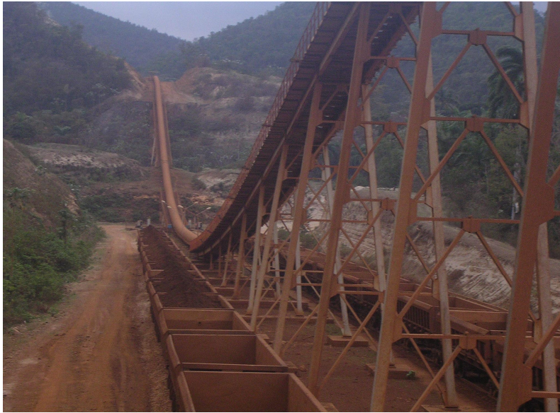
Una vista del transportador como tal, del punto 4 al punto 3 donde se ve el puente 7 y 8.
