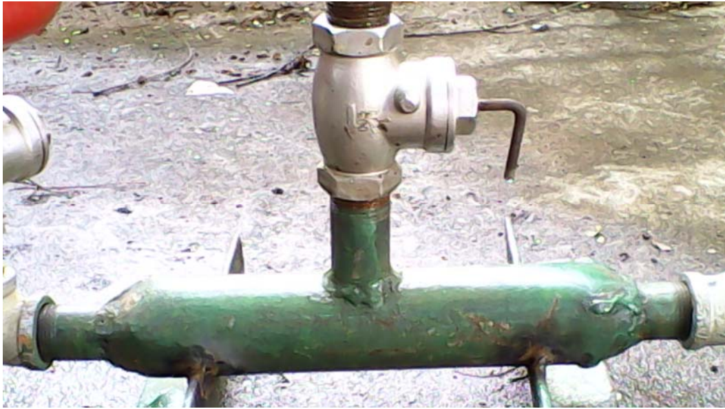
Figura 3.10. Caja de válvulas del ariete
