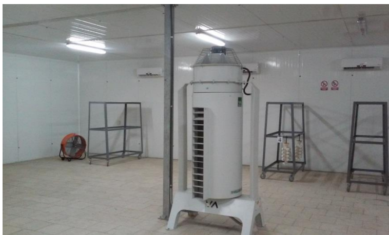
Figura 2.13 Cámara de secado.
