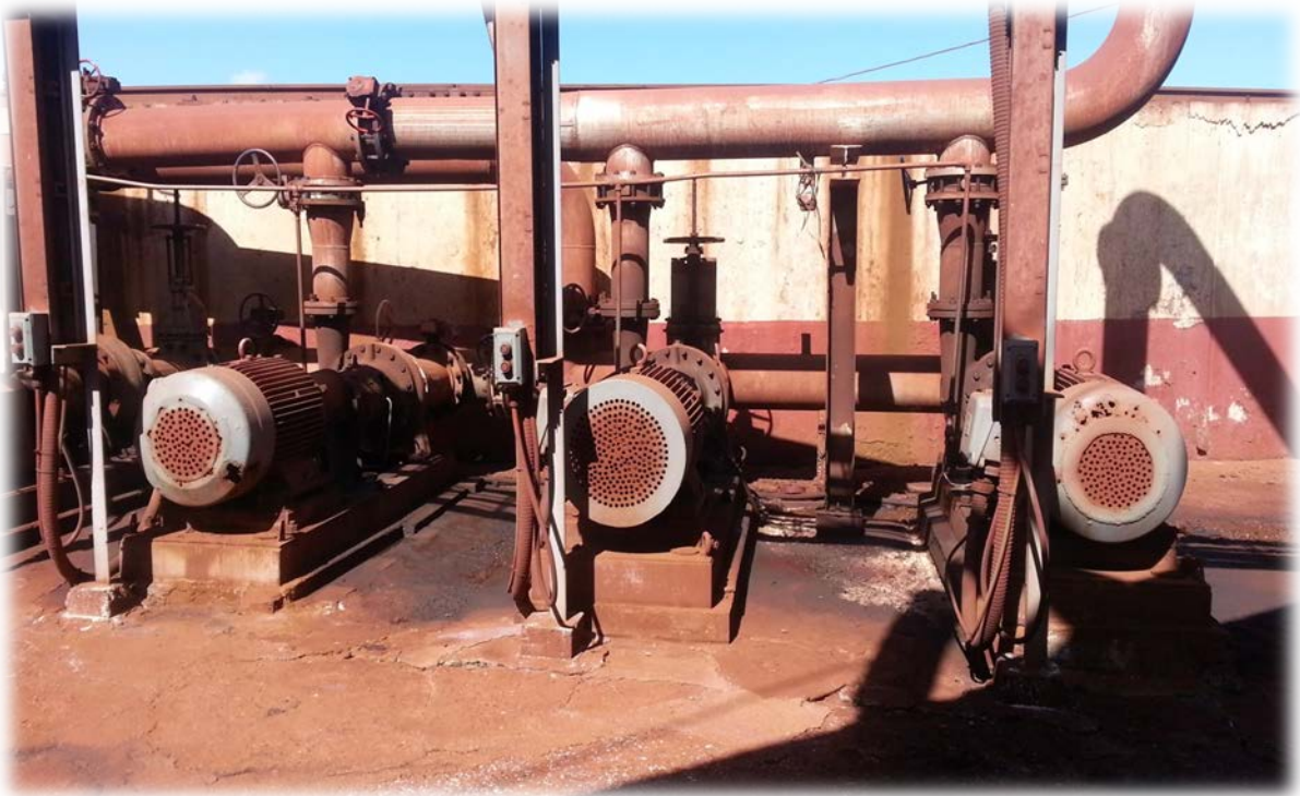
Anexo N°3. Vista de la instalación de bombas CerPELLi de la planta de Lavaderos
