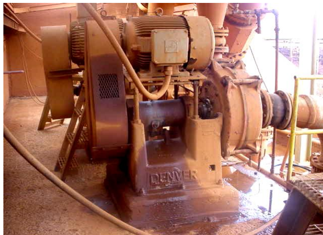
Figura 2.1.1. Bombas de flujo inferior PU – 3C y 3D.
