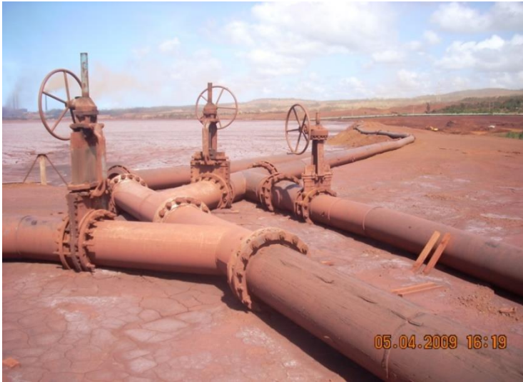
Figura 1.1. Red de tuberías para transporte de colas desde la fábrica “Comandante Pedro Sotto Alba” hasta la Presa de Colas
