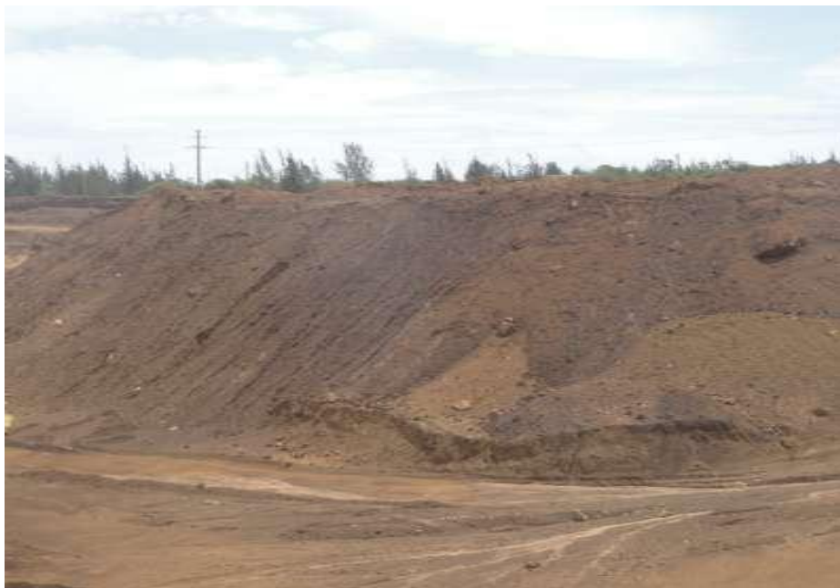
Pendiente incorrecta de las escombreras
