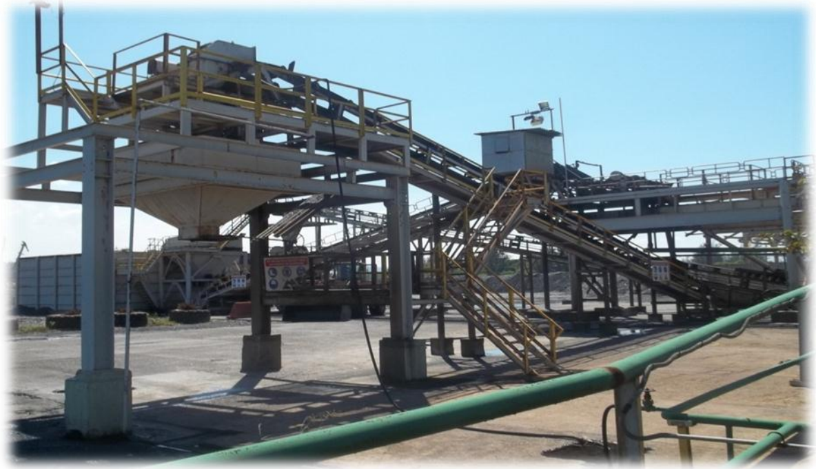
Figura 1. Planta de Beneficio de Carbón ubicada en la Empresa Puerto Moa.
