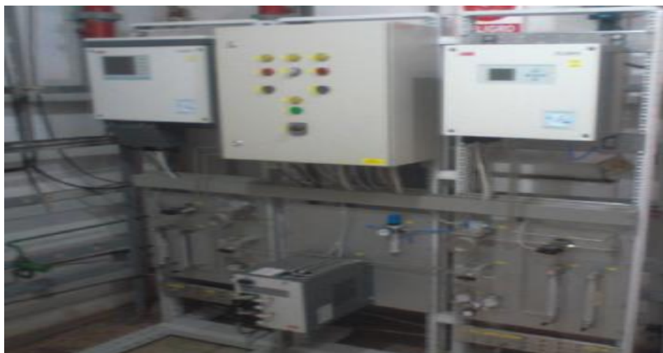
Figura: 1.7 Analizadores de Gases.
