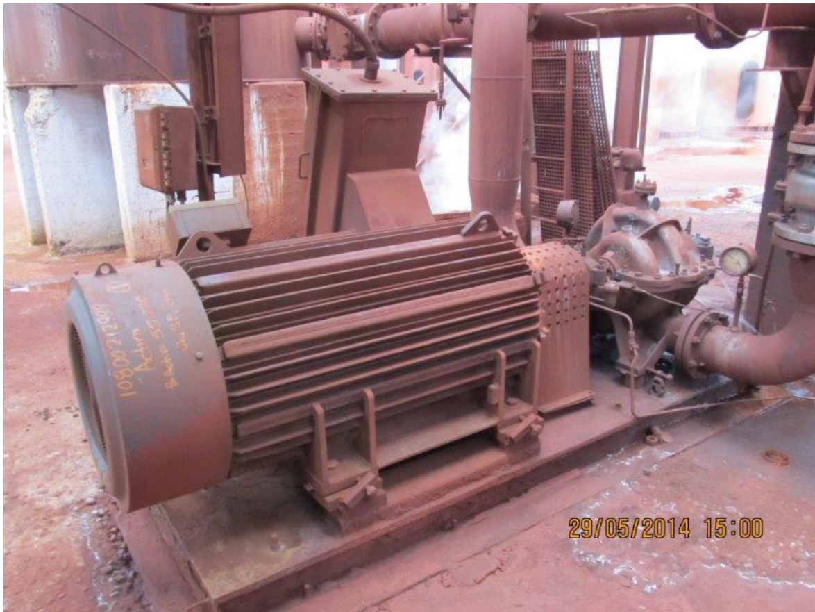
Anexo 1.6 Motor eléctrico y bomba de la planta Lixiviación.
