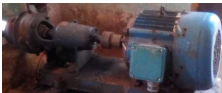
Figura 2.1. Conjunto motor - bomba
