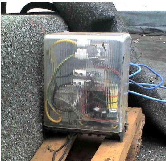
Figura 8: Armazón con circuito de control y regleta de conexión vista lateral, instalación echa en el ISMM.
