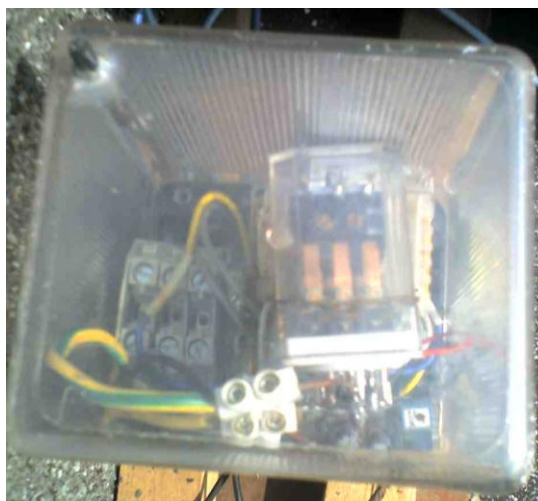
Figura 7: Armazón con circuito de control y regleta de conexión vista superior, instalación echa en el ISMM..
