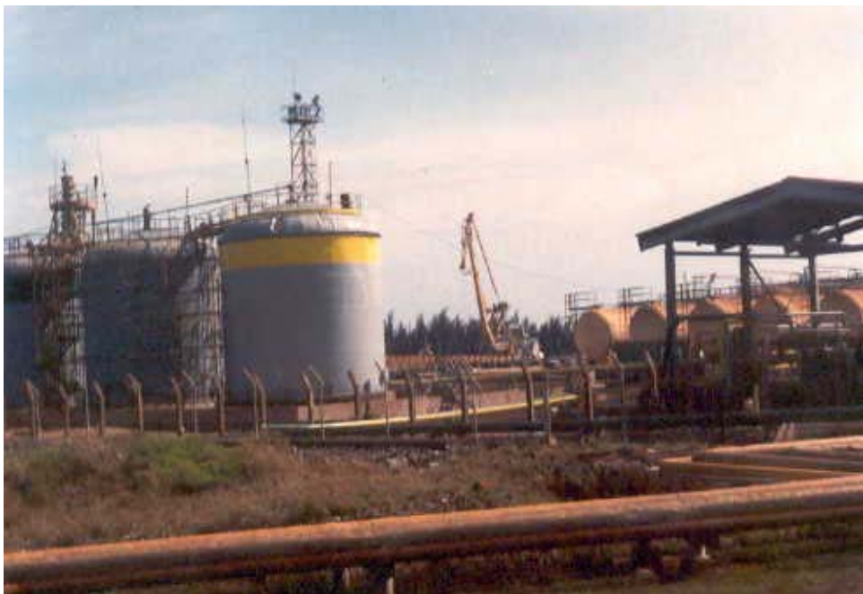
Ilustración 20 Base de almacenamiento de combustible
