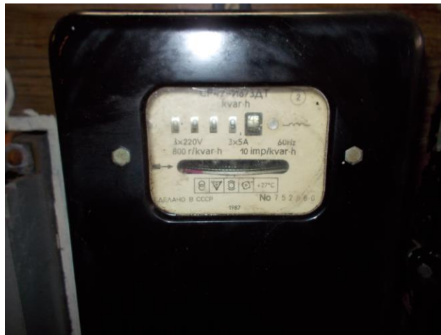
Fig.2.14. Contador de energía reactiva trifásico.
