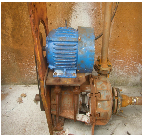
Figura. 9. Bomba centrífuga de la instalación experimental.
