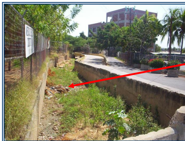
Cañada intermitente con desechos sólidos, sin mantenimiento civil.
