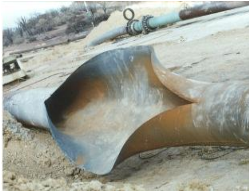
Figura 3.3. Falla total en tubería de 4" (101,6 mm)
