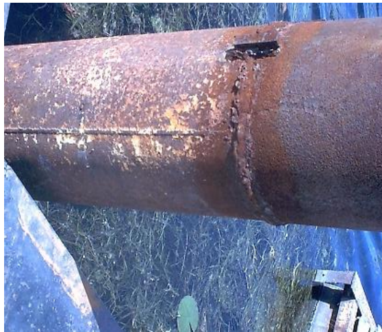
Figura 2. Grieta y corrosión en una tubería del Lago de Maracaibo
