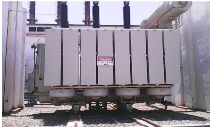
Figura 2.3 Transformador elevador conectado a la barra de salida de los generadores.
