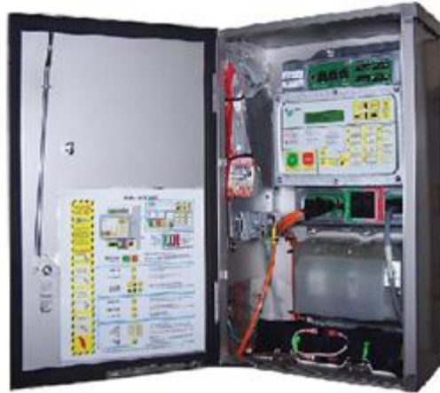
Figura 2.1 Dispositivo de protección y Medición (Nu-Lec)
