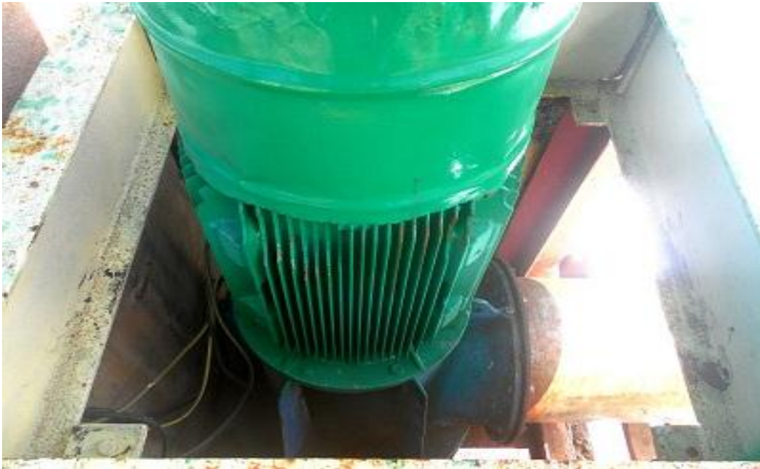
Foto de bomba exterior
