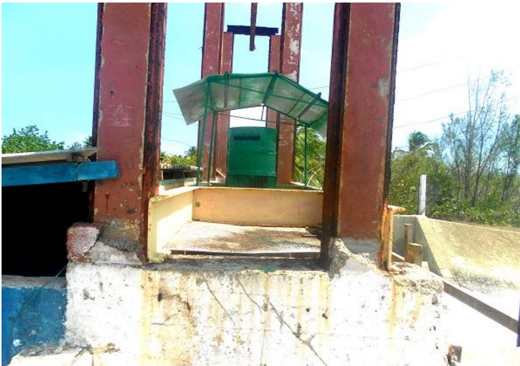
Foto de bomba exterior
