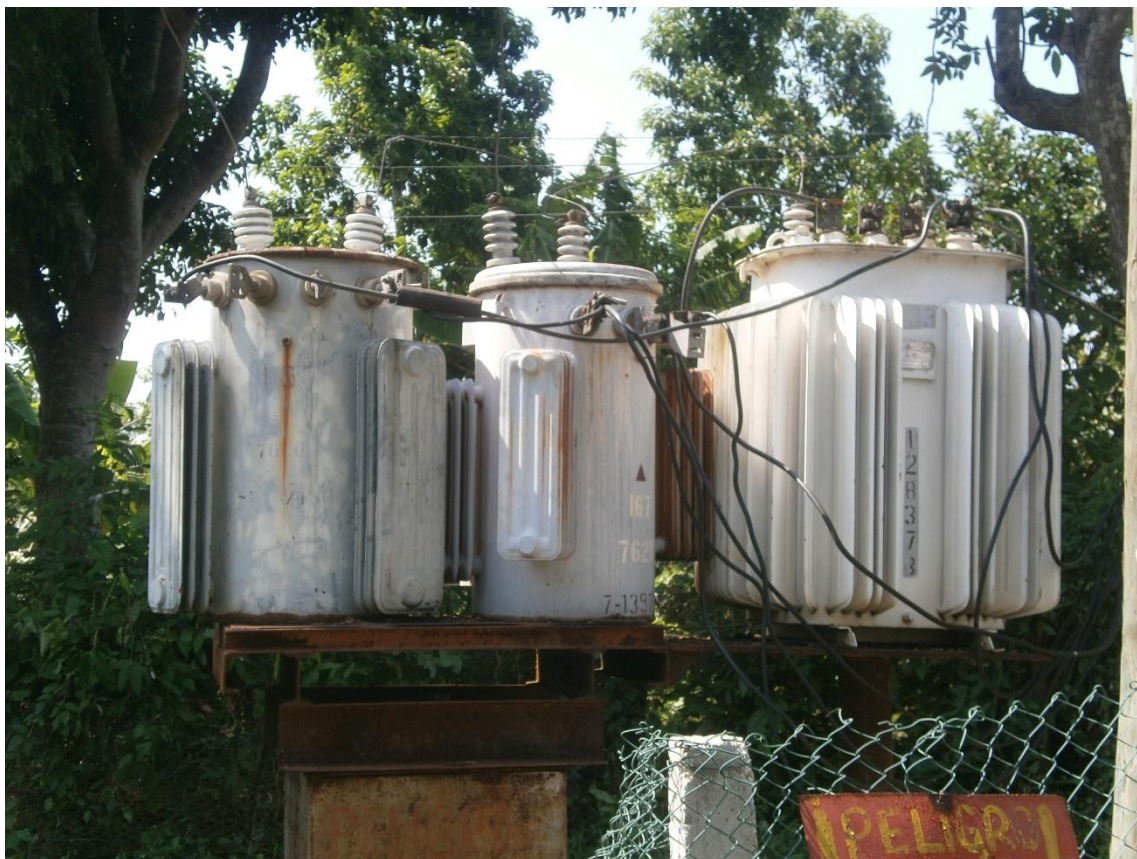
Anexo 9. Foto del banco de transformadores.
