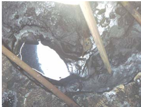
Fig. No.18: Estado de deterioro de un Tanque de Contacto
