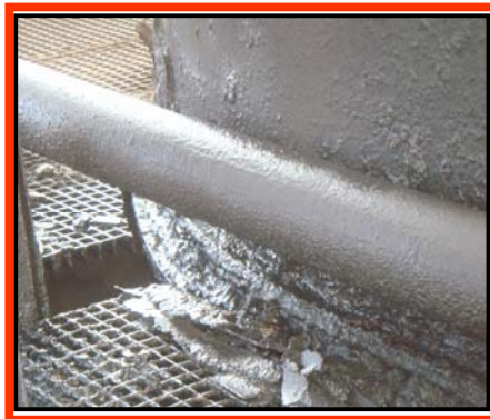
Fig. No. 21: Afectación en el fondo de un turboaereador
