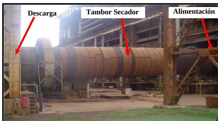
Fig. No. 5: Vista general del secadero donde se observa el punto de alimentación, el tambor y la zona de descarga
