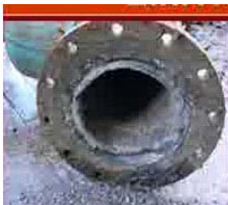
Fig. No. 13: Componente deteriorado de una bomba (Voluta)
