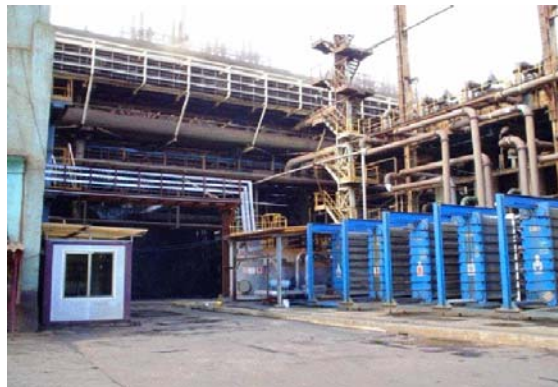
Fig No.19: Vista de los enfriadores de placas en la planta de Lixiviación y Lavado
