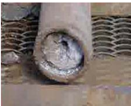
Fig. No. 16 Tubería de 100 mm sellada por las costras
