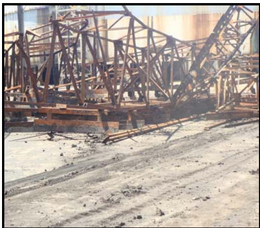
Fig.No. 22: Vista de los brazos de un sedimentador averiado
