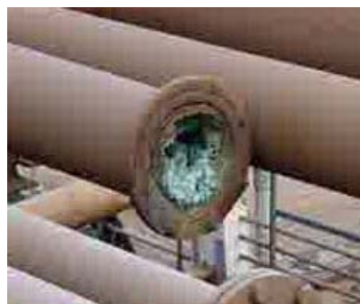
Fig. 17: Tuberías de 200 mm sellada por la acción de las costras
