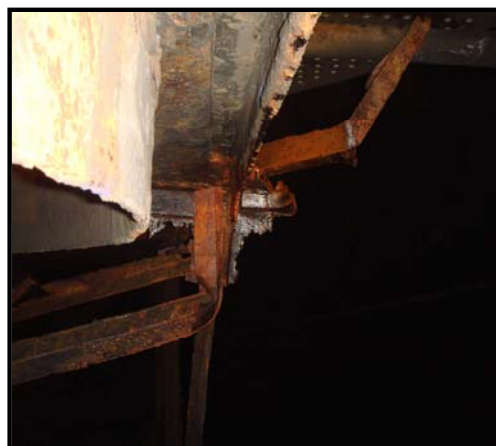
Fig.No.23: Deterioro del Feed Weell por incrustaciones de costras
