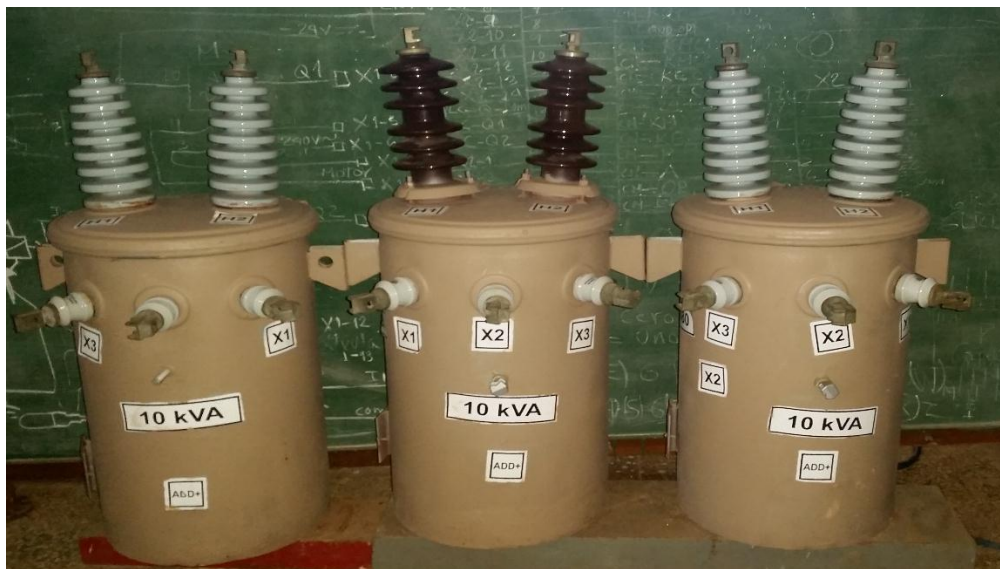
Figura 3.1 Transformadores utilizados en el Bloque B
