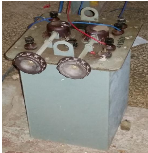
Figura 3.3 autotransformador utilizado en la contrucción del banco de pruebas
