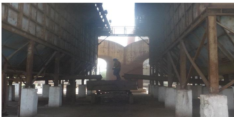
Figura 5 Planta de depuración de gases en la Empresa Acinox– Las Tunas, compuesta por filtros de manga y transportadores sinfines.
